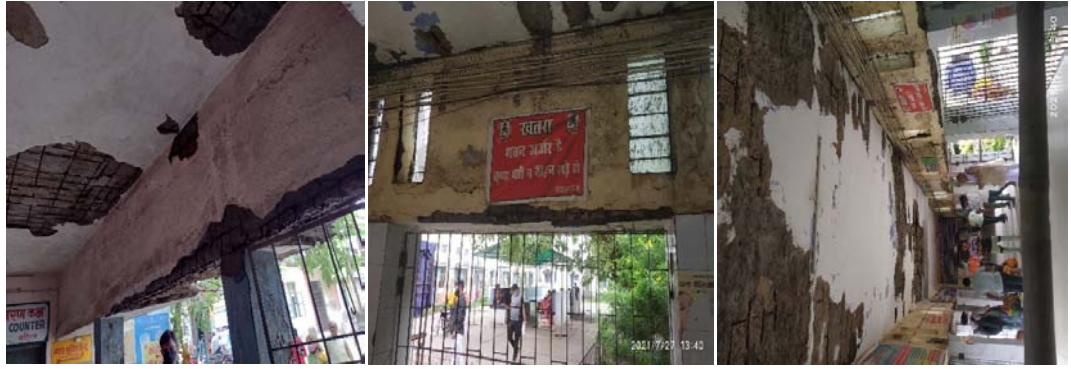
ज़ि.अ.—जहानाबाद में जर्जर अवस्था में अस्पताल की इमारत
